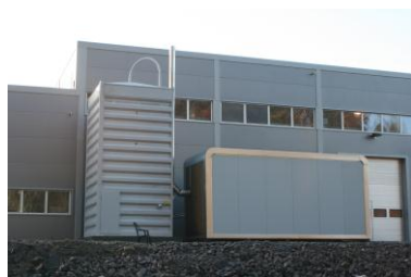
Pelletsanlegg i container
